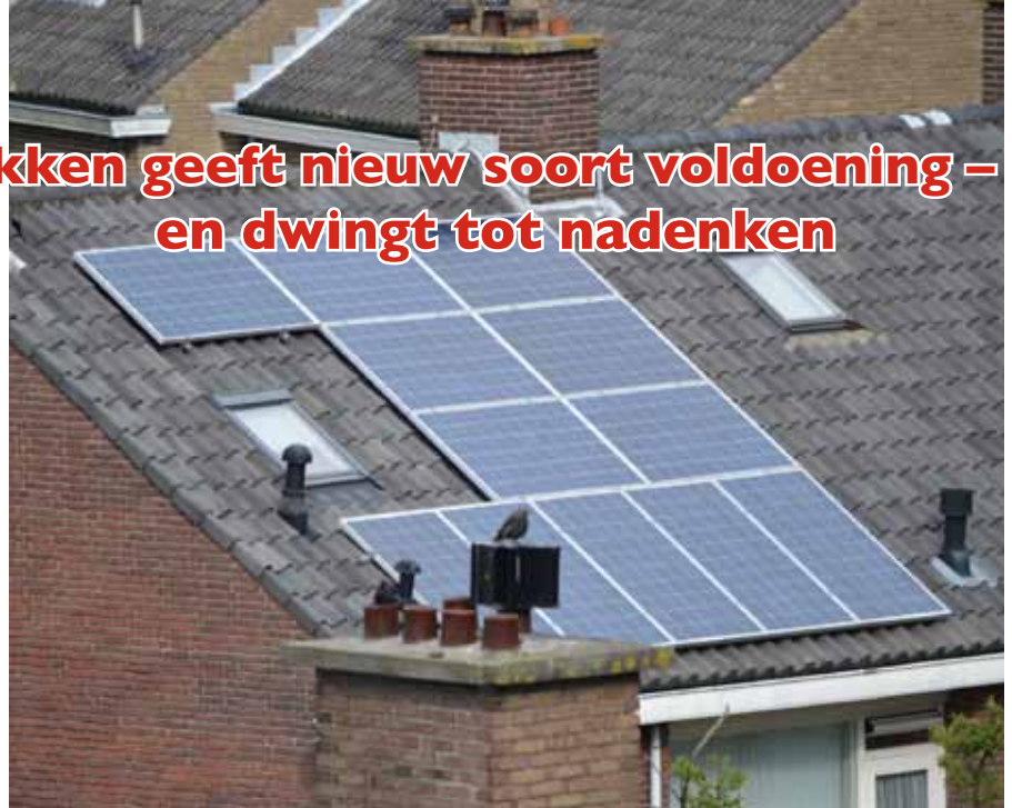
Zonnepanelen op het dak voor eigen energievoorziening. (foto: Wikimedia Commons, Steven Lek)
