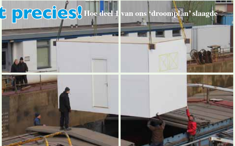
De module, hangend vlak boven de Ambivalent, luttel centimeters smaller dan de opening in het ruim... Even later gaat de module er in, perfect passend! Het gebruik van de grote werfkranaan werd ons gratis aangeboden door Scheepswerf Brouwer in Zaandam. (Foto's: Nerine Iken)
