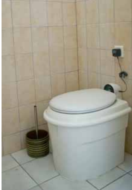
Een van de 25 nieuw geplaatste Nonolets, klaar voor gebruik.
